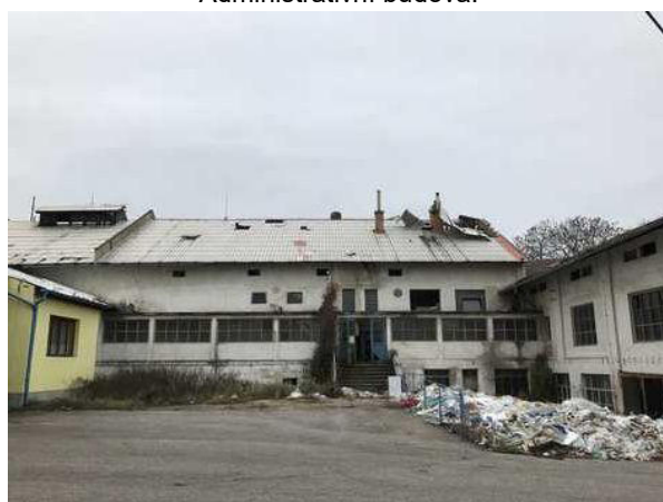
Budova bez využití ve špatném stavu.
